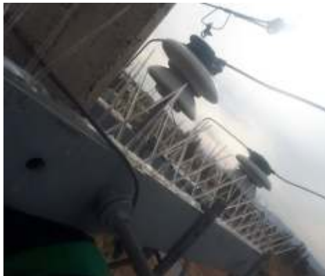
Anti-aves colocados en líneas de media tensión
